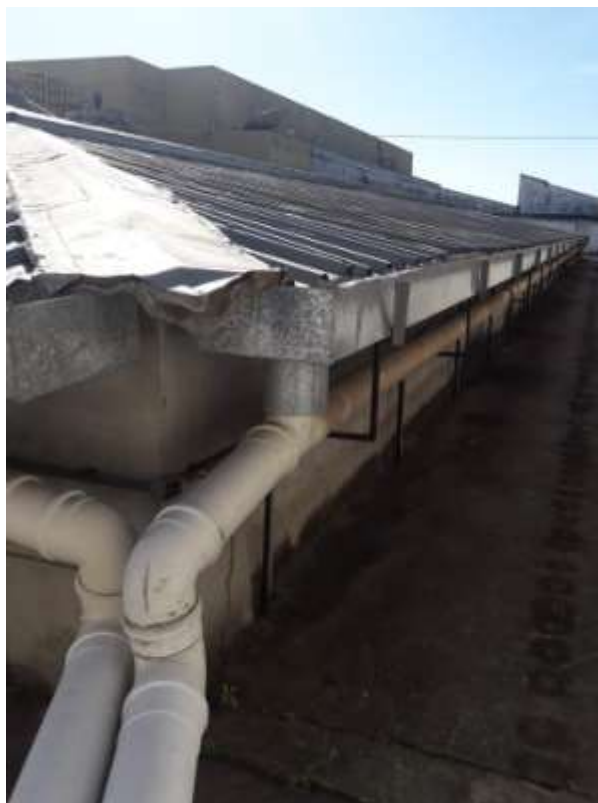
Figura 14 – Telhado, calhas e condutores instalados na cobertura do shopping center
