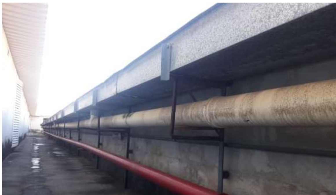
Figura 15 – Calhas de aço galvanizado e condutores de PVC do shopping center
