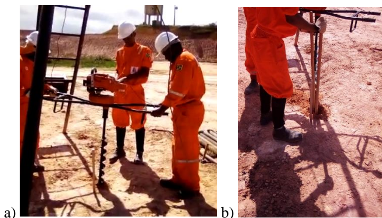
Figura 3.17 – a) Escavação inicial utilizando o trado helicoidal mecânico. b) Retirada do resíduo de solo com auxílio da cavadeira boca de lobo
