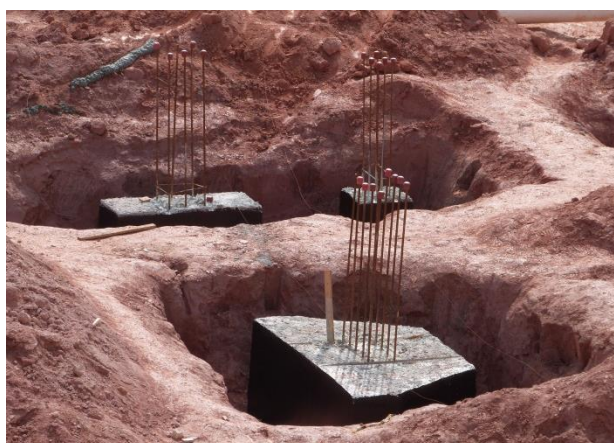
Figura 3.13 – Blocos de coroamento com ferros de prontos para a execução dos pilares.
