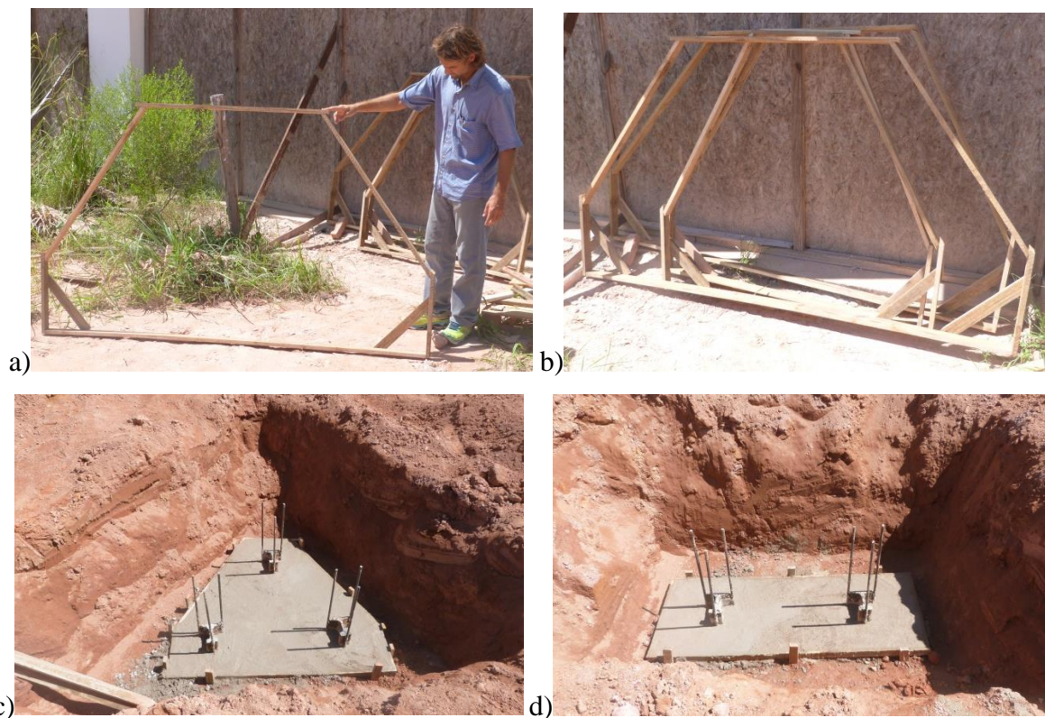
Figura 3.12 – a) e b) Moldes para o concreto magro dos blocos de coroamento; c) e d) Concreto magro executado.
