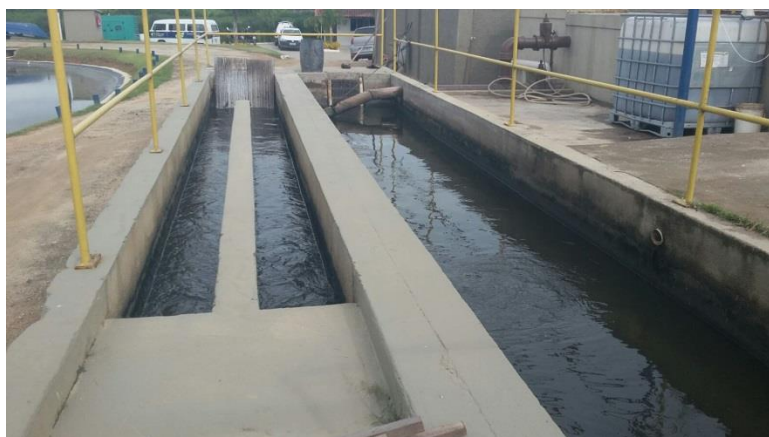
Figura 3-3 - Caixa de areia em ETE
