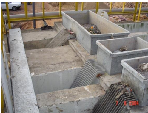
Figura 3-2 – Sistema de gradeamento em ETE
