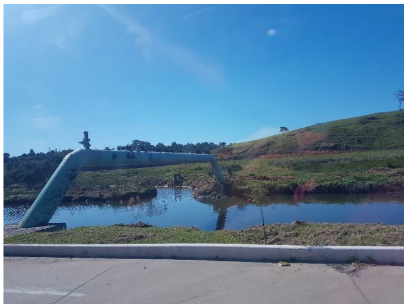
Figura 15: Adutora no Canal do Capote
