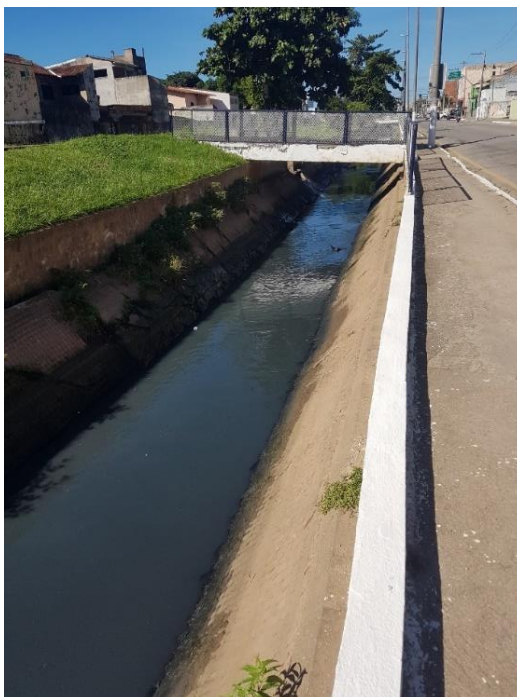
Figura 25: Canal Fabio Franco em formato trapezoidal com o revestimento soltando em sua extensão.
