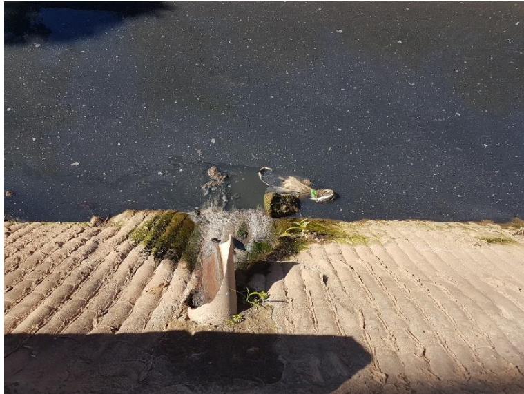
Figura 24: Tubulação com ligação clandestina de Esgoto no canal Fabio Franco
