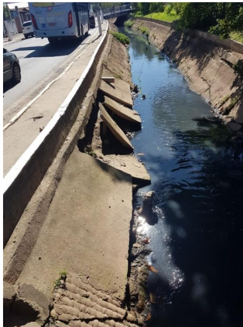
Figura 23: Estado do revestimento do Canal Fabio Franco
