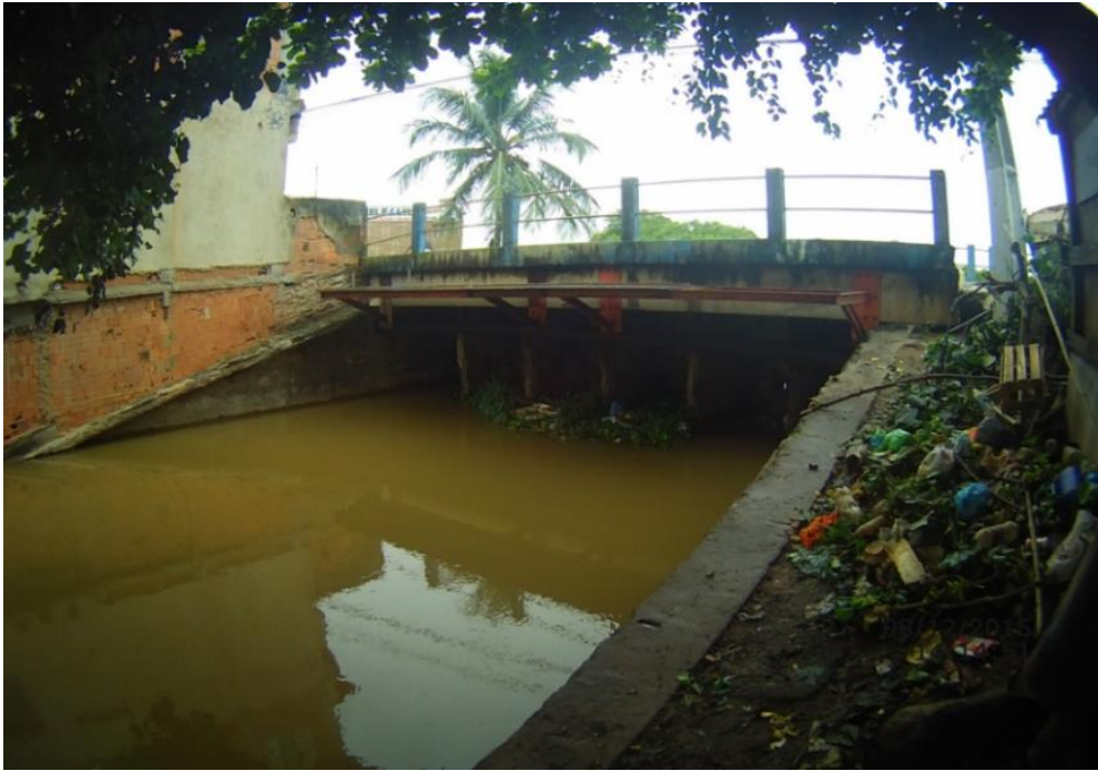
Figura 32: Canal Virgem Santa com possível entupimento
