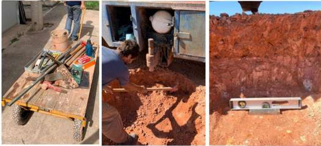
Figura 6.10 – Transporte dos equipamentos do laboratório para o campo experimental e escavação manual.
