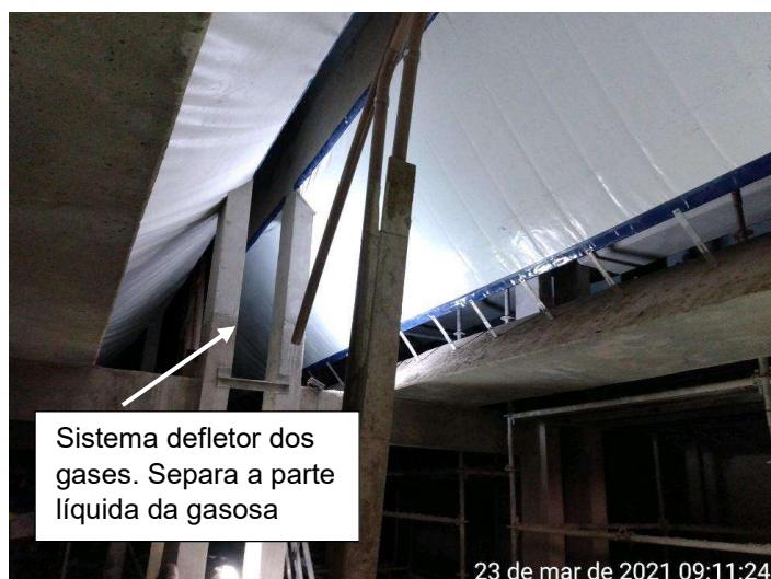
Figura 4: Defletor de gases visto do interior de um UASB (ETE Mariléa, Rio das Ostras - RJ).
