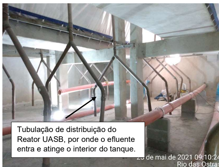
Figura 1: Tubos de alimentação vistos do interior de um UASB (ETE Mariléa, Rio das Ostras – RJ).
