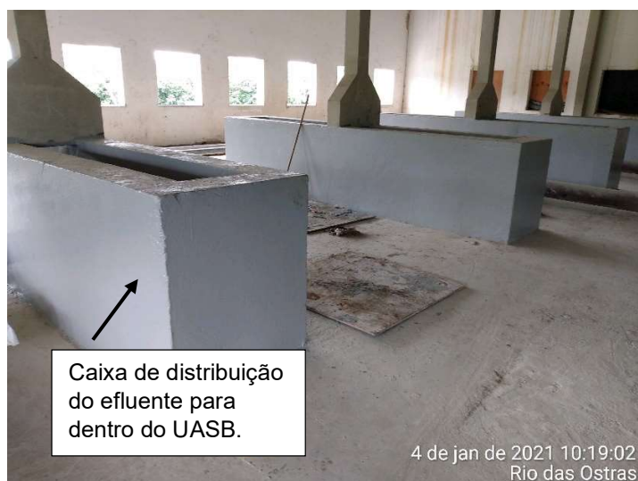
Figura 3: Caixa de distribuição do UASB (ETE Mariléa, Rio das Ostras – RJ).
