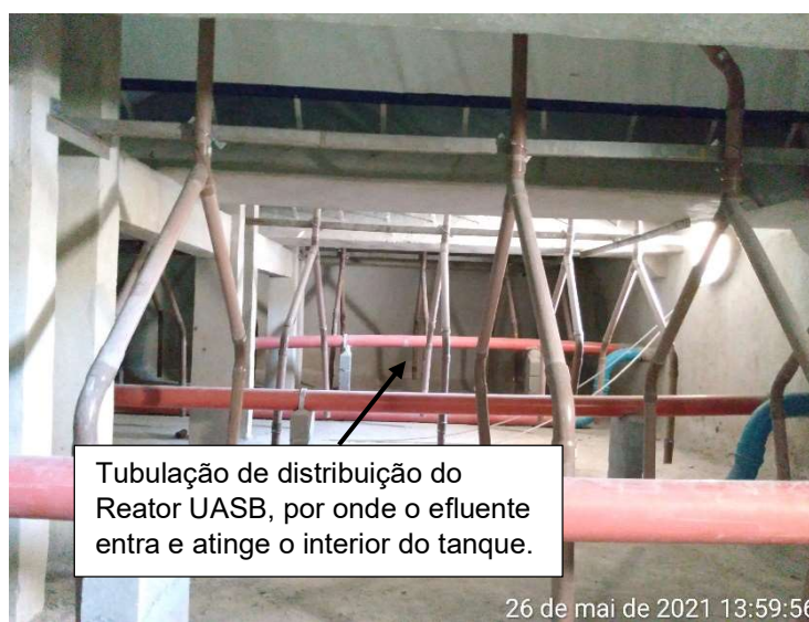
Figura 2: Tubos de alimentação vistos do interior de um UASB (ETE Mariléa, Rio das Ostras – RJ).
