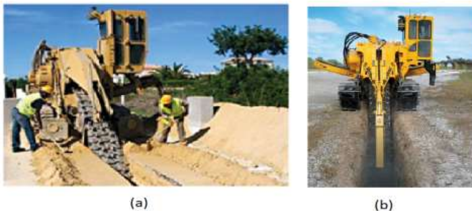
Figura 3.3 - As valadoras em ação durante a execução de valas a céu aberto. Fonte: https://www.vermeer.pt/produtos/escavacao-especializada/abertura-de-vala/Valadoras-sobre-Rastos-com-Lanca-de-Escavacao/64/ (acessado em 26/06/2021).
