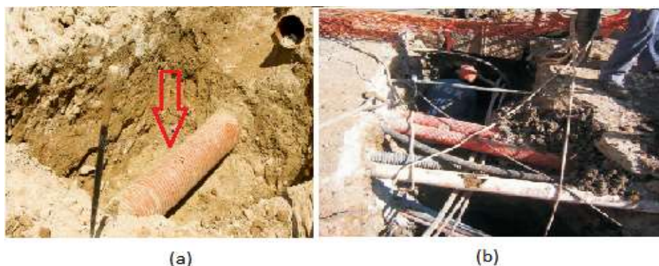
Figura 3.1 - Exemplos de interferências ocorridas em escavações. Fonte: https://www.copel.com/hpcopel/root/sitearquivos2.nsf/arquivos/redes_de_distribuicao_subterraneas/$FILE/RedesDeDistribuicaoSubterraneas-5.pdf (acessado em 02/08/2021).
