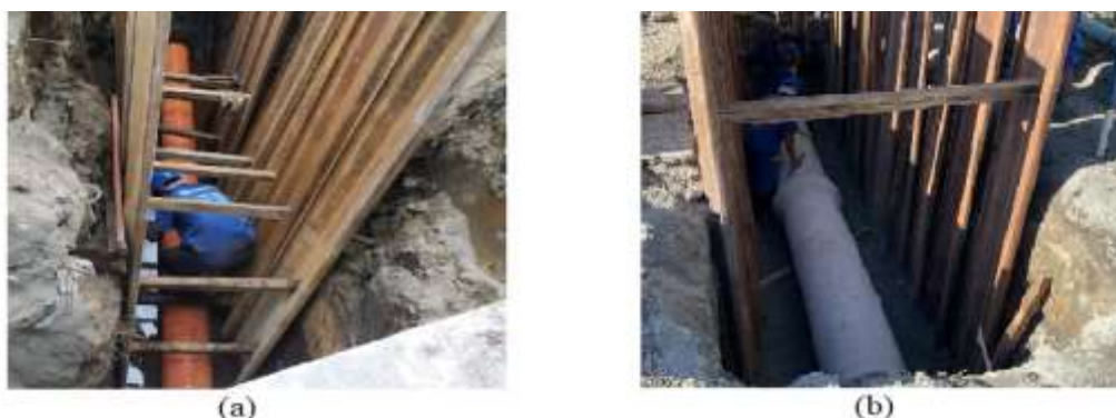
Figura 4.25 - Assentamento de tubulação em PVC e concreto armado na execução de rede coletora de esgoto.
