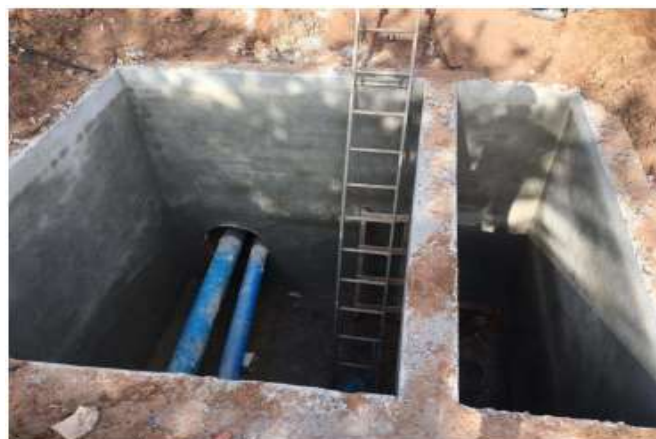
Figura 3.16 - Redes de esgoto com tubos DN150 e DN200 instaladas com perfuração por cravação no Rio Grande do Norte. Fonte: Silva (2019).
