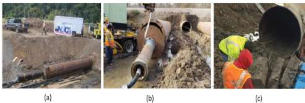
Figura 3.14 - Sequência executiva de tubo guia para instalação de nova rede sobre uma rodovia. Fonte: http://web.engr.oregonstate.edu/~stuedlea/P_PipeRamming.php (acessado em 06/07/2021).
