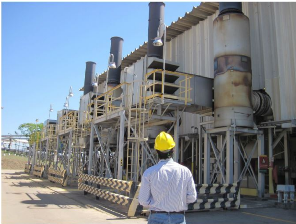
Figura A.1: Estação de Compressão - Unidade I
